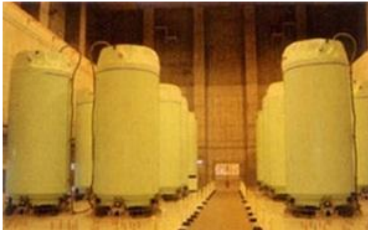
日本原子力発電(株)東海第二発電所での乾式貯蔵
